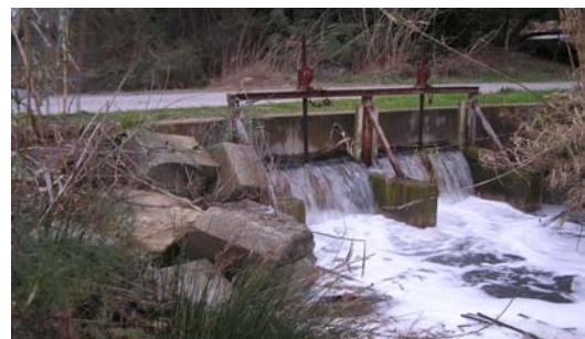
Fig 10 Refoulement de la surcote des eaux du Ponant dans le collecteur principal N-E de La Grande Motte en raison d'un retard de fermeture de la martelière du Ponant (novembre 2008). Une mise à jour des automatismes et des pompes est nécessaire.
